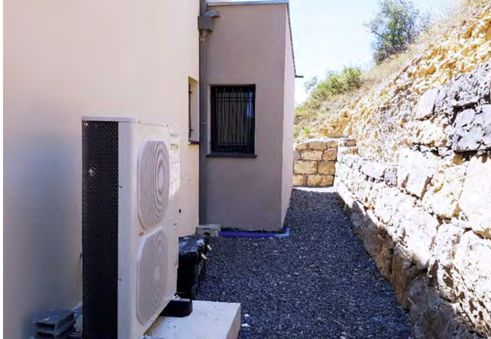
▲ Bild 2 • Die Außeneinheit auf einem Betonsockel vor der Schallschutzwand.
